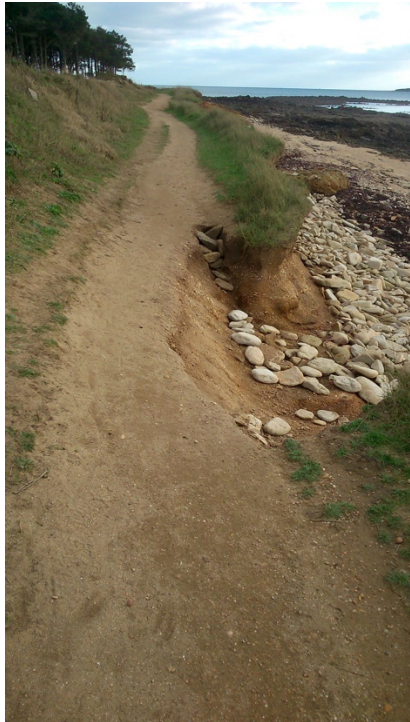
Portion de sentier côtier érodé au niveau de la Pointe Er Hourel
